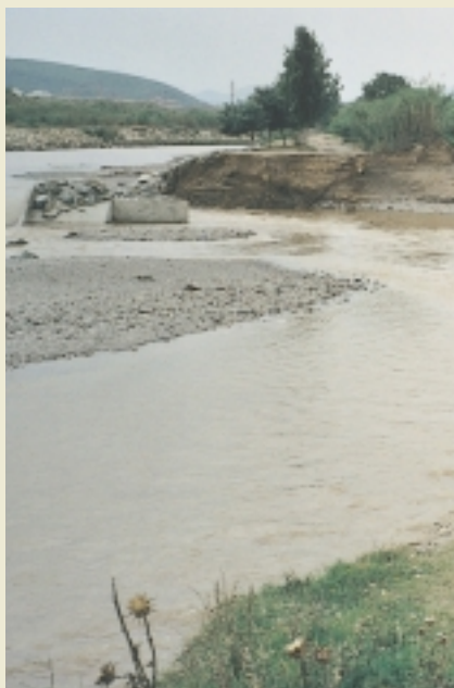
Trencament del marge esquerre del riu Llobregat a la resclosa del canal de la Dreta a Molins de Rei, provocat per la riuada del dia 10 de maig.
