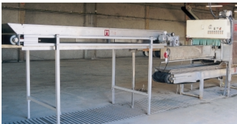
■ La màquina netejadora ja està instal·lada a la nau.
