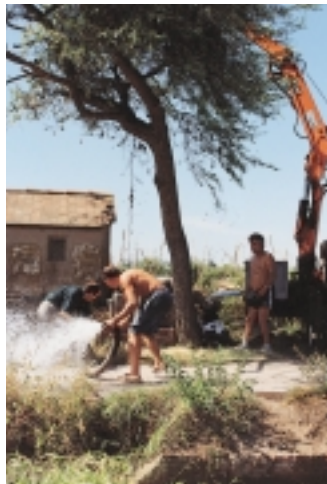
Aforament del pou
